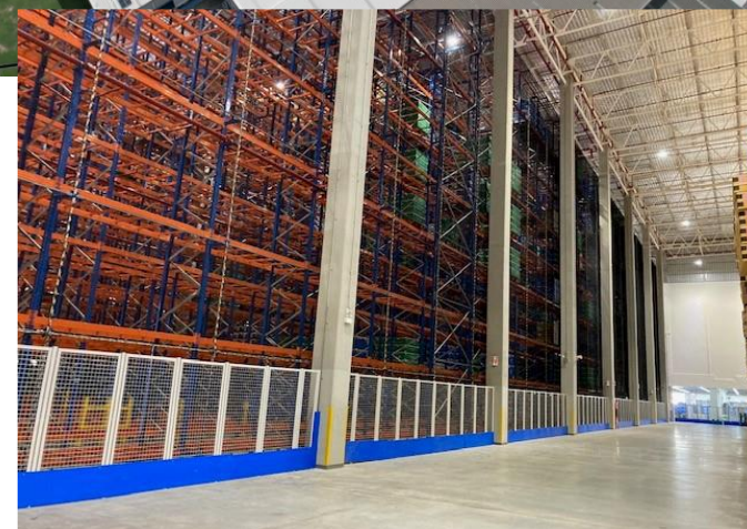
倉庫内に自動倉庫を設備
